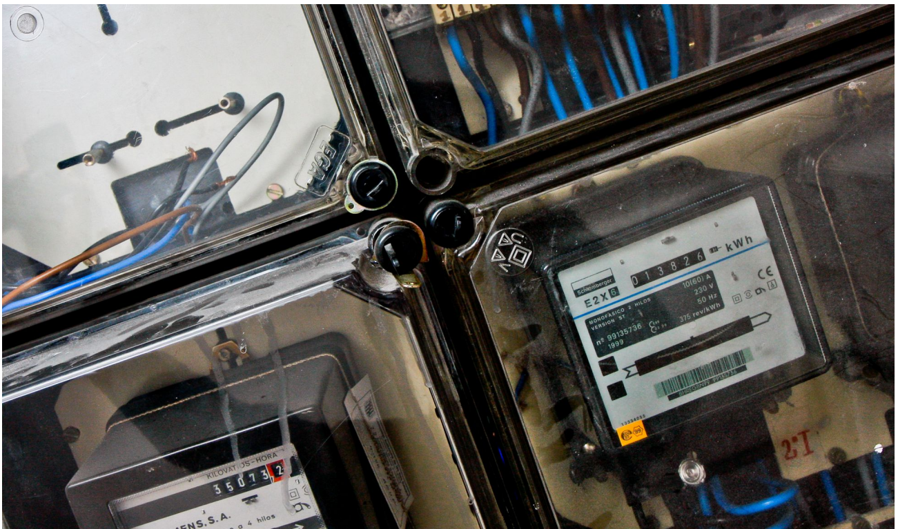
Contadores de electricidad. /TOLO RAMÓN
